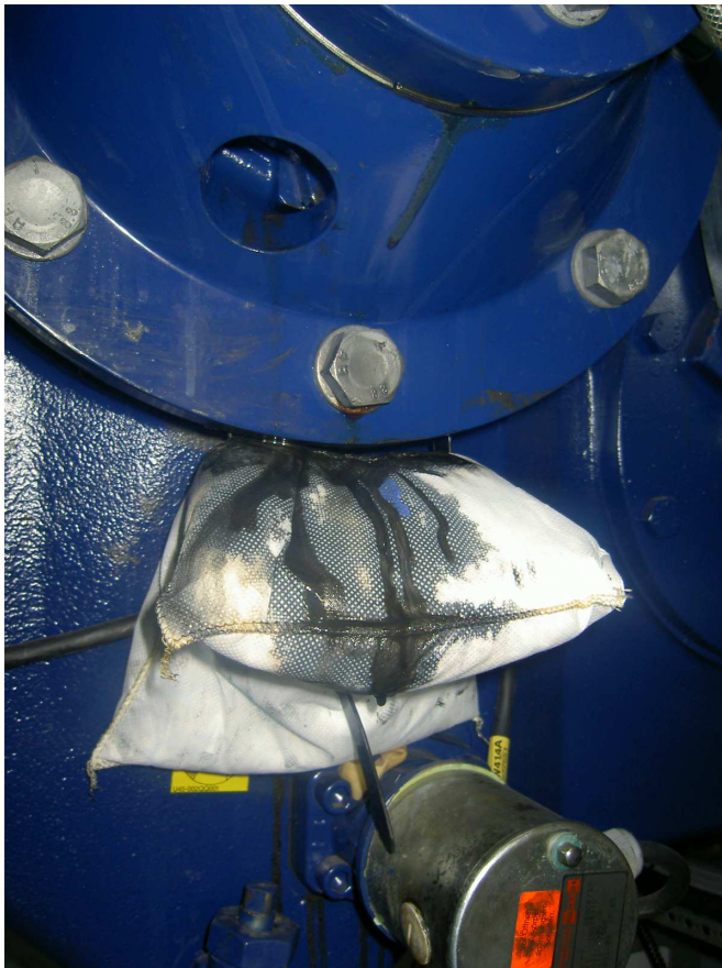
Olielekkage bij langzame as
